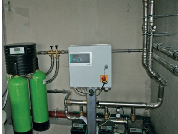
Druckerhöhungsanlage für Regenwassernutzung
