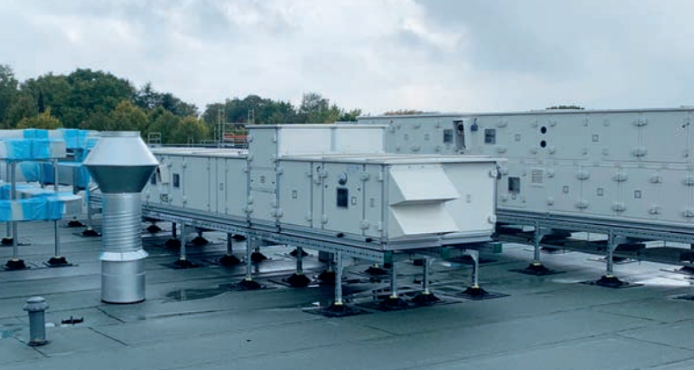
Lüftungszentralgeräte auf dem Dach
