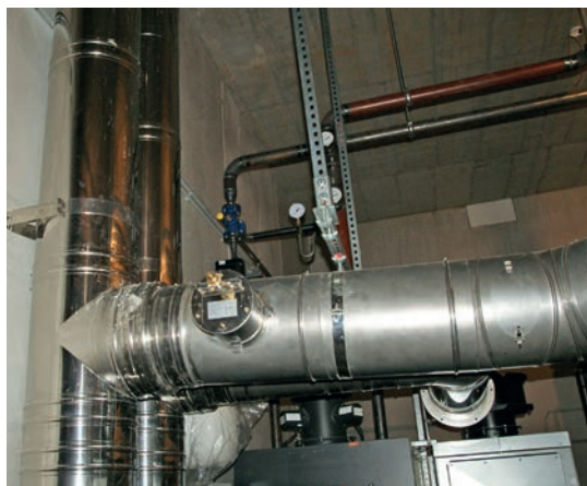
Abgasleitung des Holzkessel
