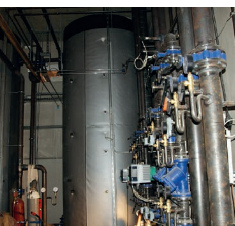
Pufferspeicher der Heizungsanlage
