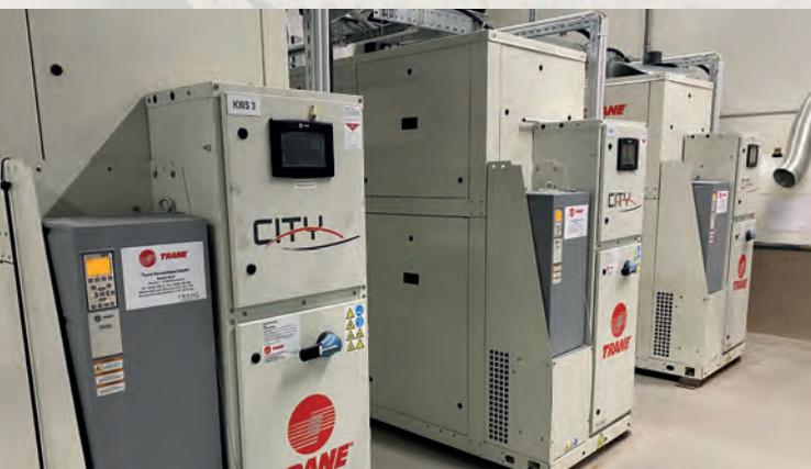
Die drei Kaltwassersätze
