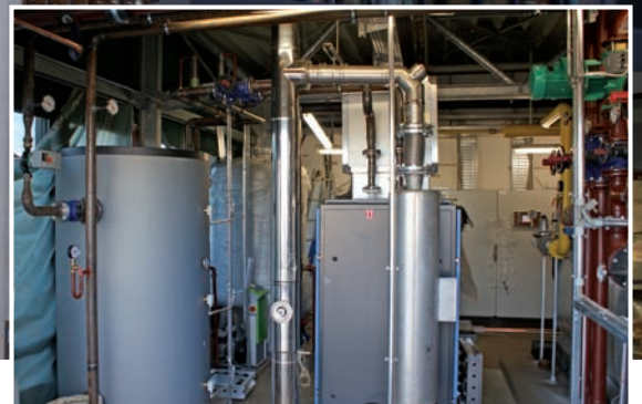
Kältemaschine und Verteilung
