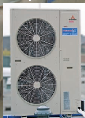
Klimaanlage auf dem Dach
