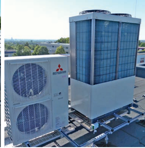
Wärmepumpe mit Klimaanlage
