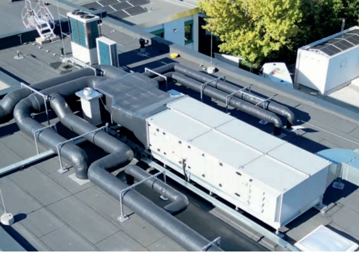
Lüftungsanlage auf dem Dach
